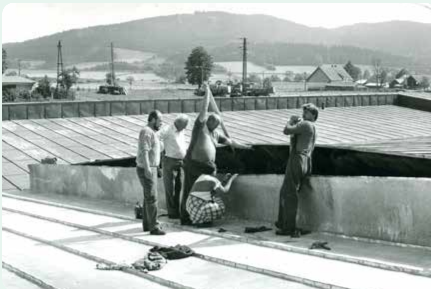
Kontrola poškozené střechy.
